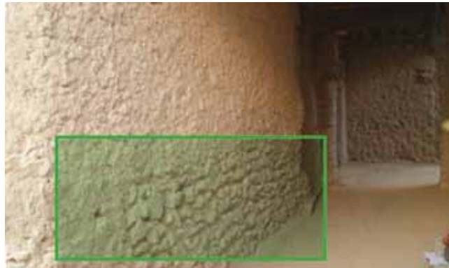
Érosion du couronnement
