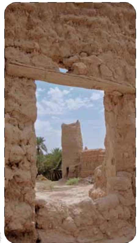
Edifice en voie de dégradation
