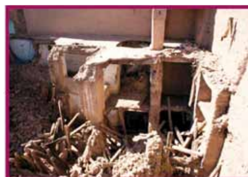
B/2- DEGRADATION DES SYSTEMES HORIZONTAUX (déformations et ruptures des éléments porteurs/pourritures des couvertures horizontales)
