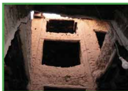
B/1- DÉGRADATION DE L'ENVELOPPE (cassures dues à l'érosion et au ruissellement/ la fissuration)
