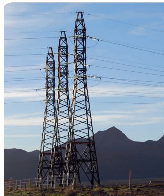
L'Oriental, innervée d'autoroutes électriques sous haute tension
