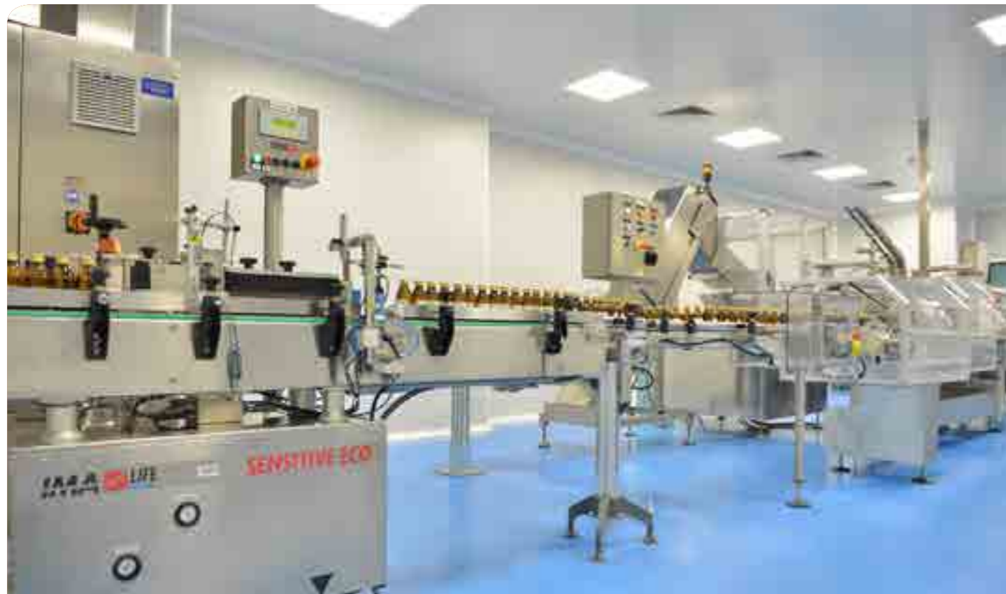
Chaîne de remplissage de bouteilles de sirop installée au Maroc
